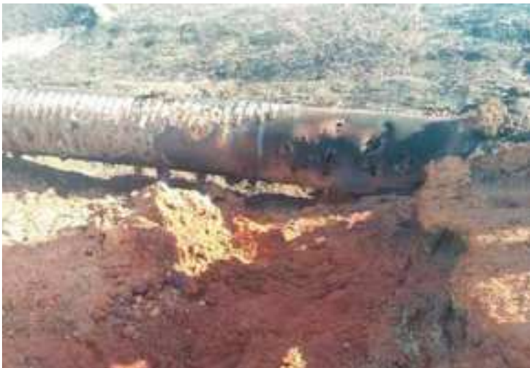
Пошкодження газогону на Донеччині
